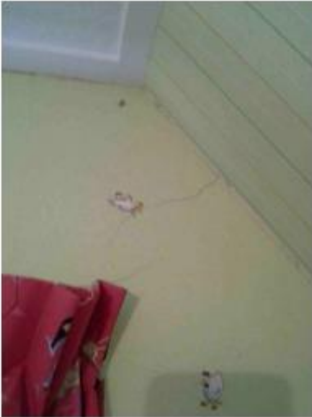
Woning, 1e verdieping, ruimte 3 (slaapkamer): Wand 3, scheur (licht 0 - 2 mm, diagonaal)
