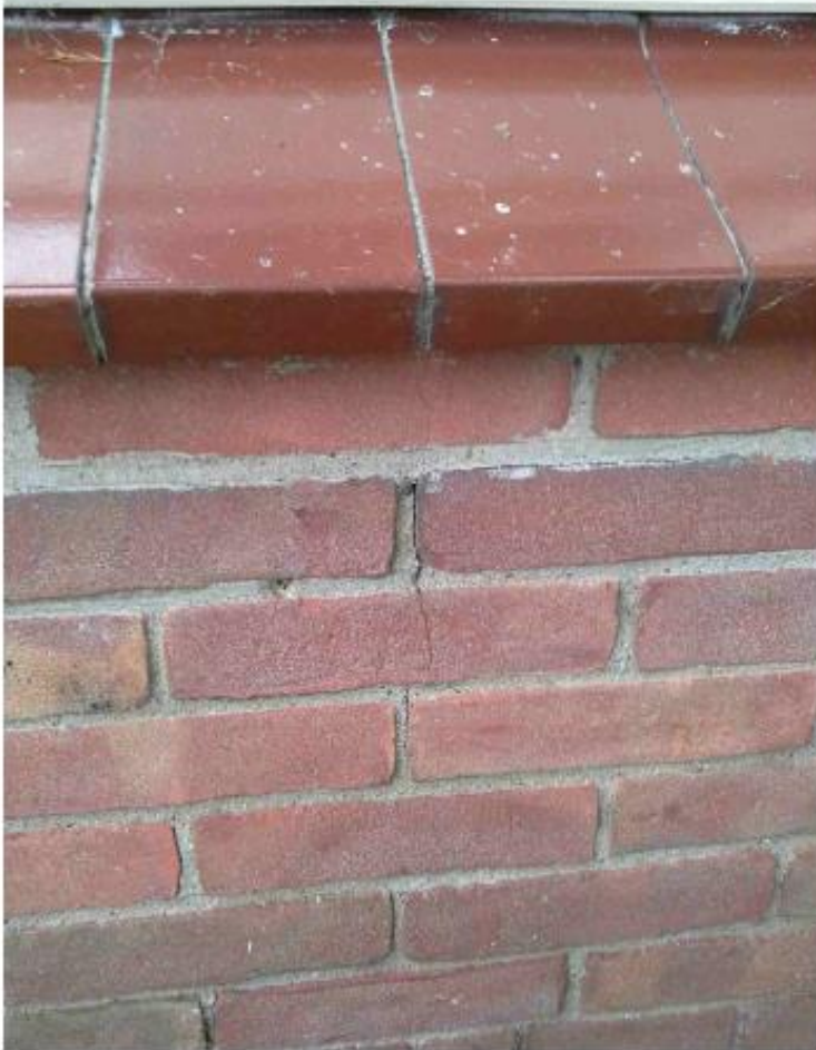
Woning, Voorgevel: Scheur, (licht 0 - 2 mm, verticaal)
